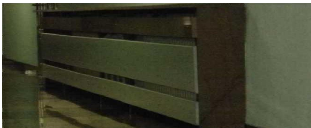
Фигура 2 – Отоплителни тела в сграда на адрес: гр. Русе, ул. „Асен Златаров“ №26
