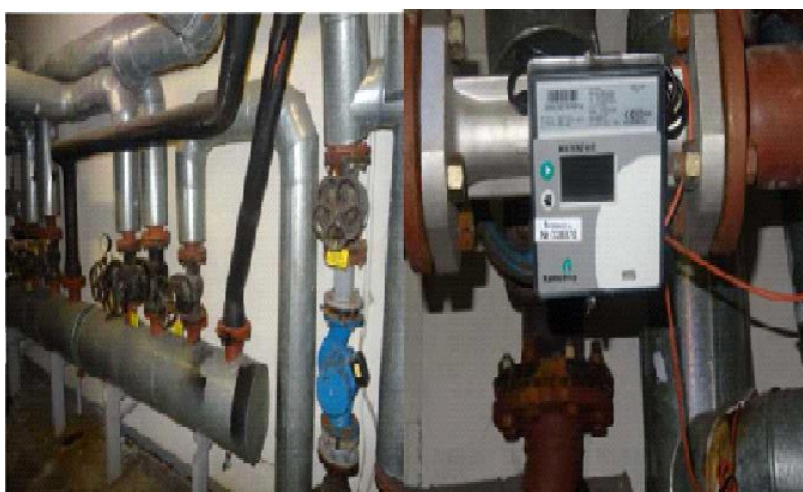
Фигура 1 – Абонатна станция в сграда на адрес: гр. Русе, ул. „Асен Златаров“ №26
